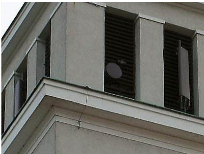
Zdj. 2. Przykłady urządzeń w istniejących instalacjach
